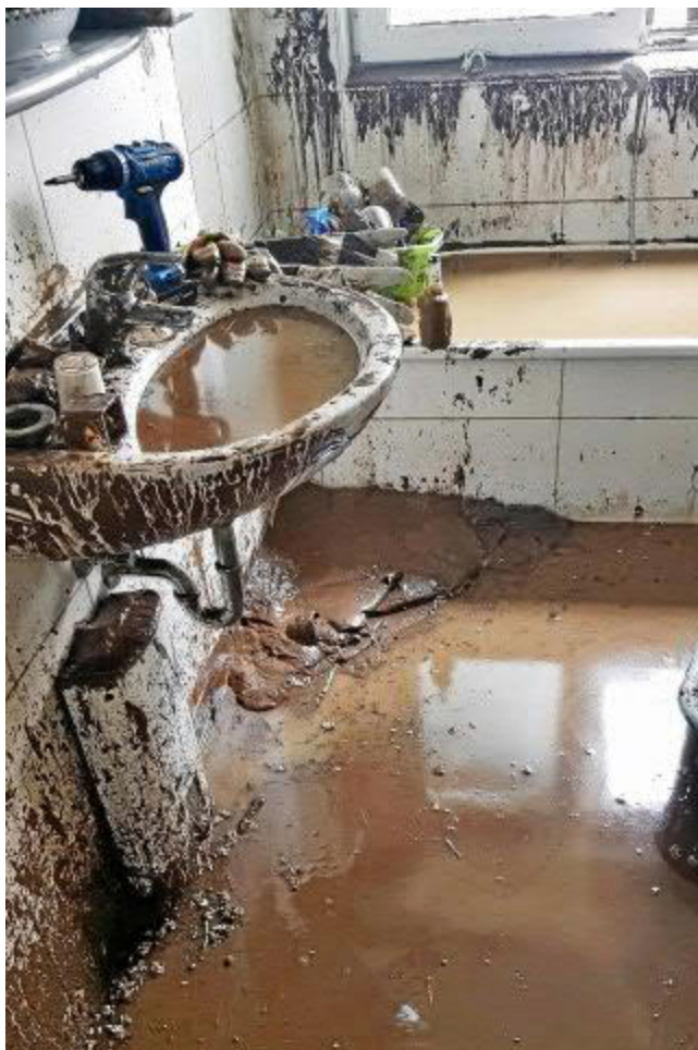
Braune Schlammlawine im Badezimmer Foto: Privat
